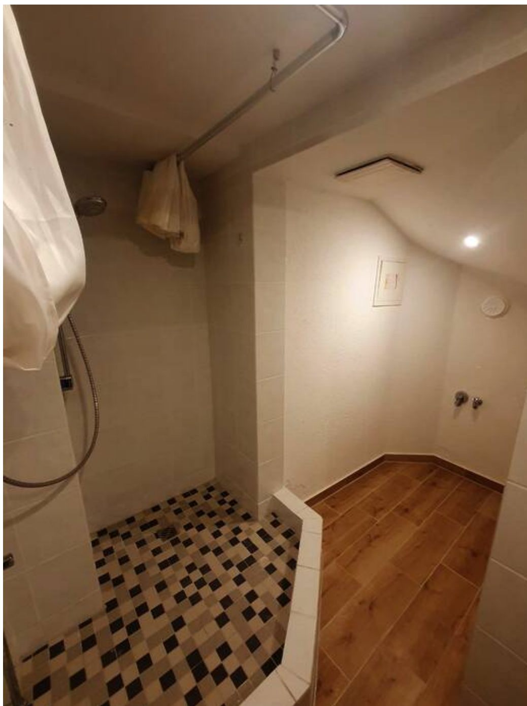
Dusche u. WM-Anschluss
