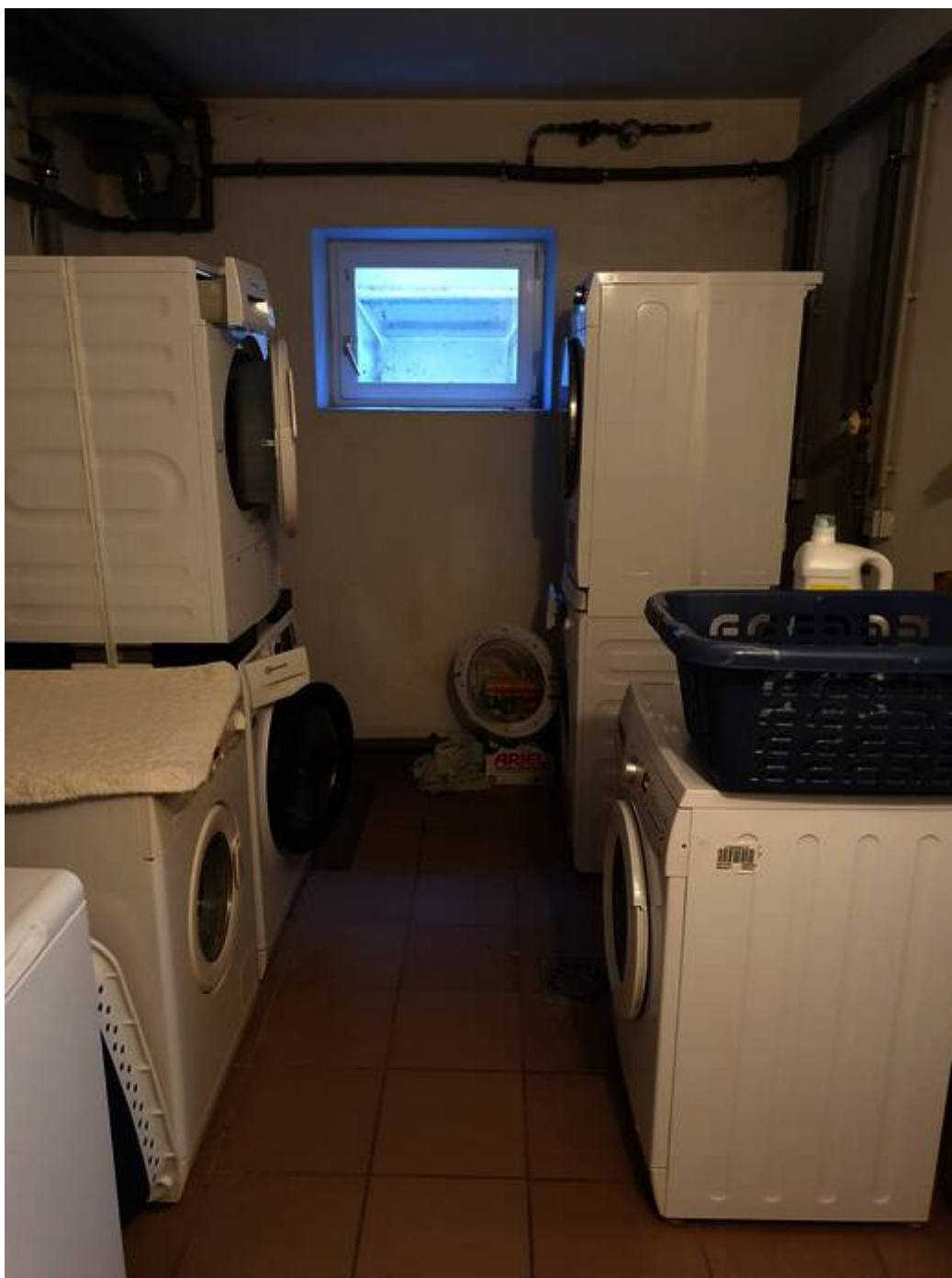
WM-Anschluss im Keller
