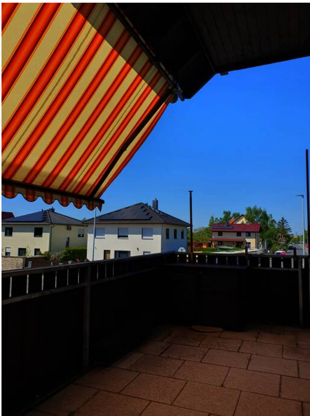
Südbalkon mit elektrischer Markise
