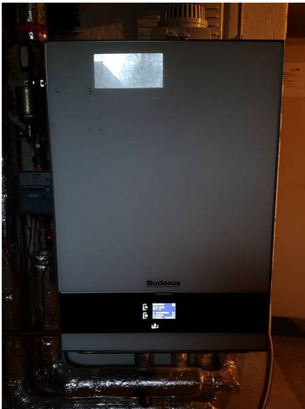
Brennwerttherme mehrfach erneuert
